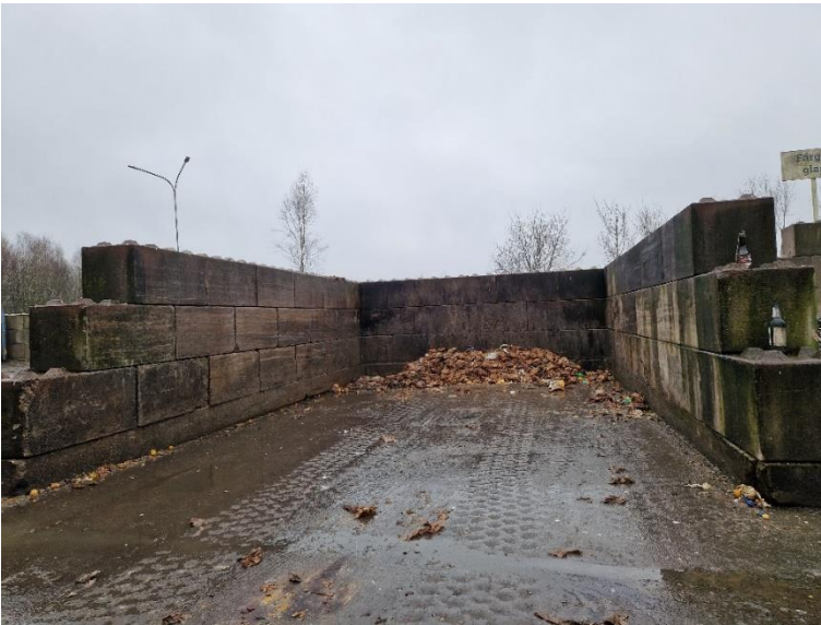
Figur 7-2. Tillfällig lagringsplatta för matavfall utomhus.
